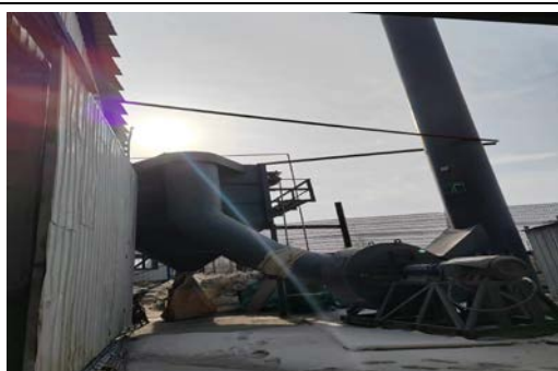
颚式破碎机除尘器
